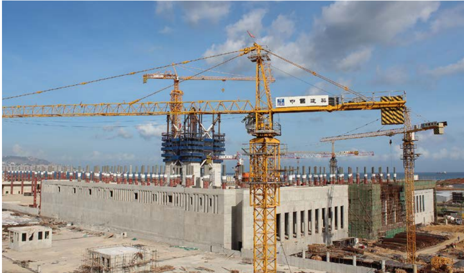
Rohbau Esplanade, Minarett | Oktober 2015 (oben) Visualisierung Moscheekomplex (links) Seismische Isolierung Gebetssaal (unten)
